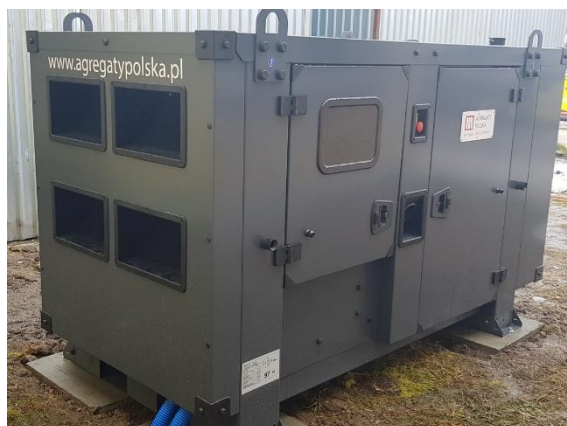
Fot. Agregat prądotwórczy wraz z układem SZR zamontowany na stacji uzdatniania wody w Kamieniu Krajeńskim
